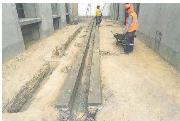
canaletas en zona de recepción de alimentos.
